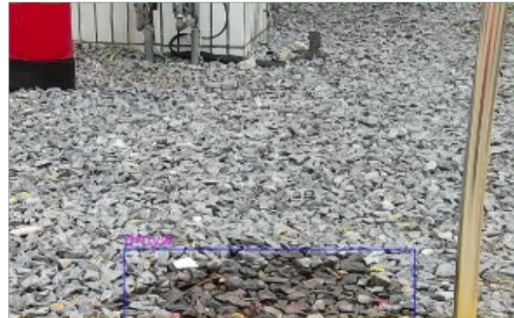
砂利道路での漏れ検知
