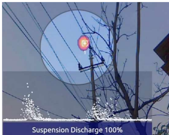
サスペンション部分放電100%
